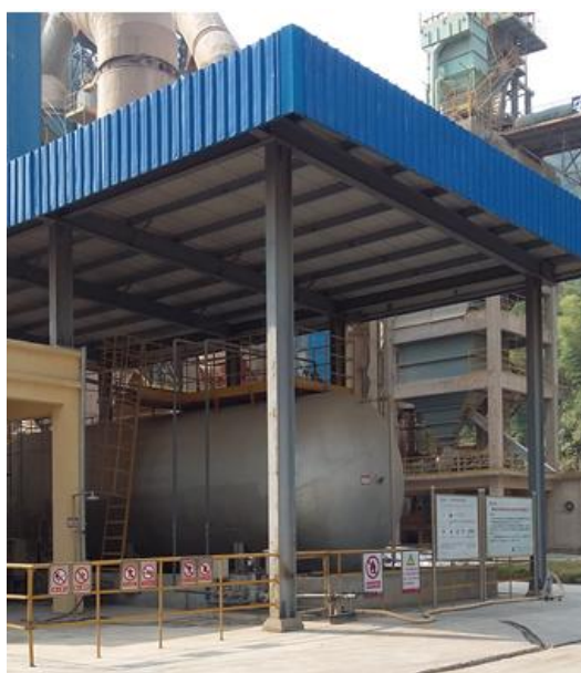
图 5 脱硝还原剂储存制备区
